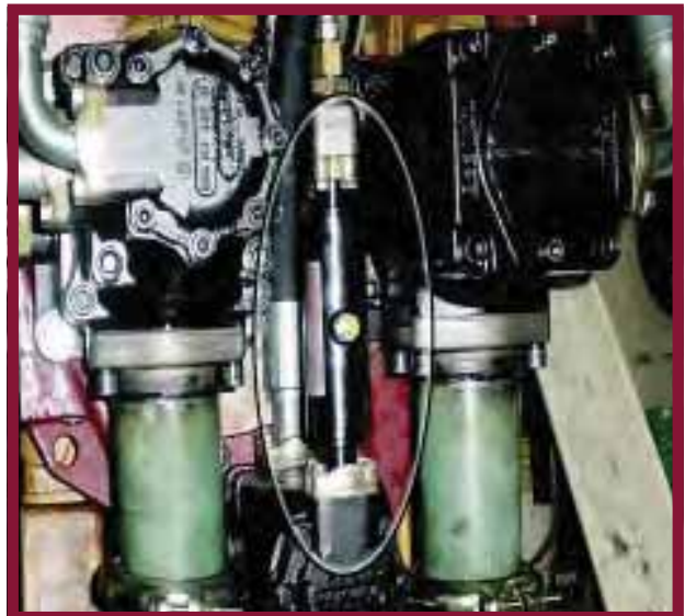
图片显示，在泵的出口处用法兰安装着一个消声器。
