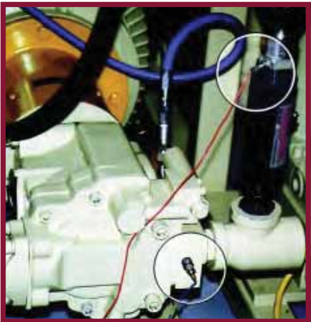
这个图片显示，该消声器安装在泵的出口处，消声器的前后安装了两个传感器，和示波器连着。目的是为了获取下面的扫描图。
